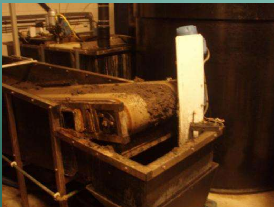
pásový dopravník odvodněných koagulovaných exkrementů
